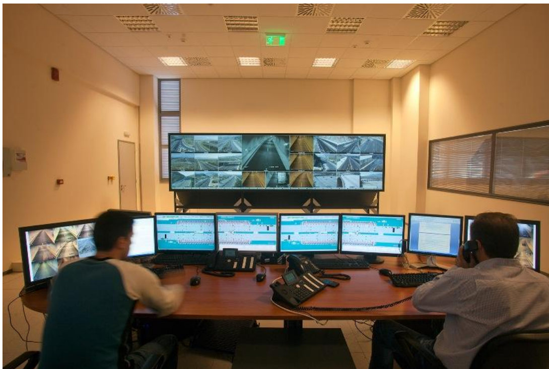
Άποψη : Κέντρο Ελέγχου Κυκλοφορίας ΚΕΣ Νεστάνης
